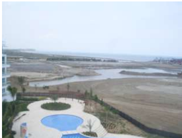
Seguimiento y control de obras "proyecto karibaná" efectuada el día 07 de julio de 2011.
