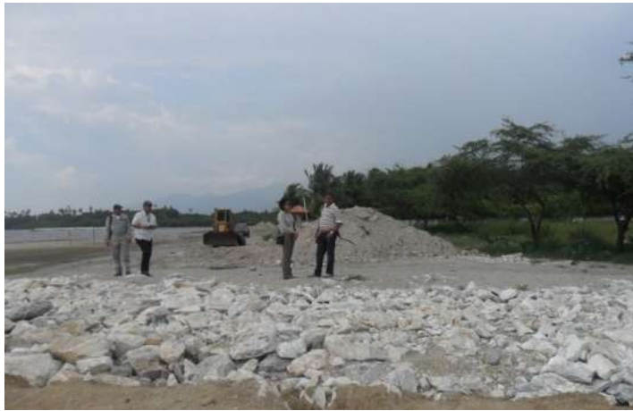
Obras de protección otorgadas por la Dirección General Marítima a la Gobernación del Magdalena, sector Costa Verde, municipio de Ciénaga.
