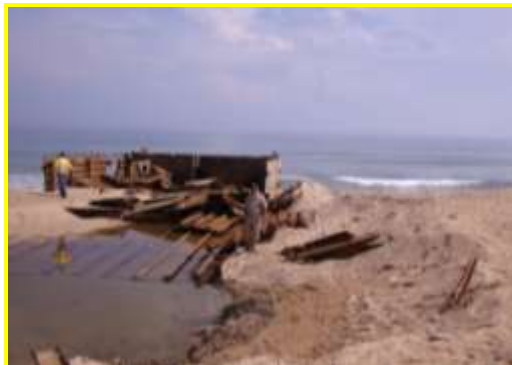
Foto 11.: Inspección litoral sector conocido como playa malla norte agosto 2011.
