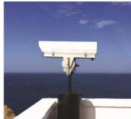
▲ Circuito cerrado de televisión (CCT)
