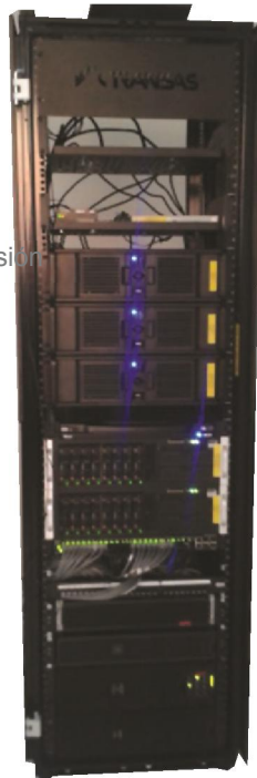
▲ Rack el Sistema de Control de Tráfico y Vigilancia.
