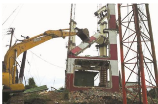
▲ Construcción de la Estación de Control de Tráfico Marítimo en Tumaco, Nariño.
