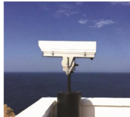
▲ Circuito cerrado de televisión (CCT)
