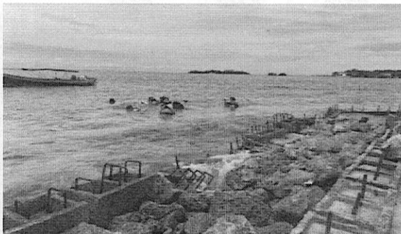
Imagen No 5. Se realizan actividades acuáticas sin ningún control cerca a un muro de contención en estado de deterioro.
